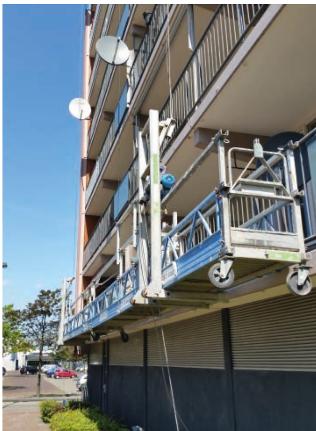
Foto 3: De constructie veilig achterlaten na werktijd
